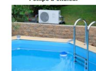
Pompe à Chaleur
